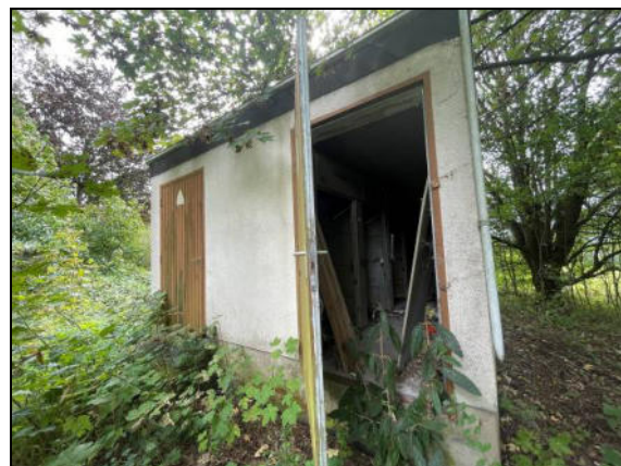
Abb. 15: Trafohäuschen Foto: M. Grenz (18.09.2023)
