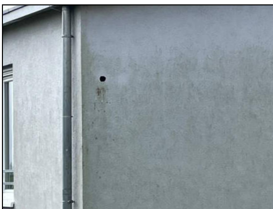
Abb. 14: Spechthöhle in Dämmung Foto: M. Grenz (21.04.2023)
